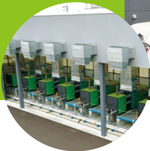
バイオマス変換工場 バイオガス発電所
